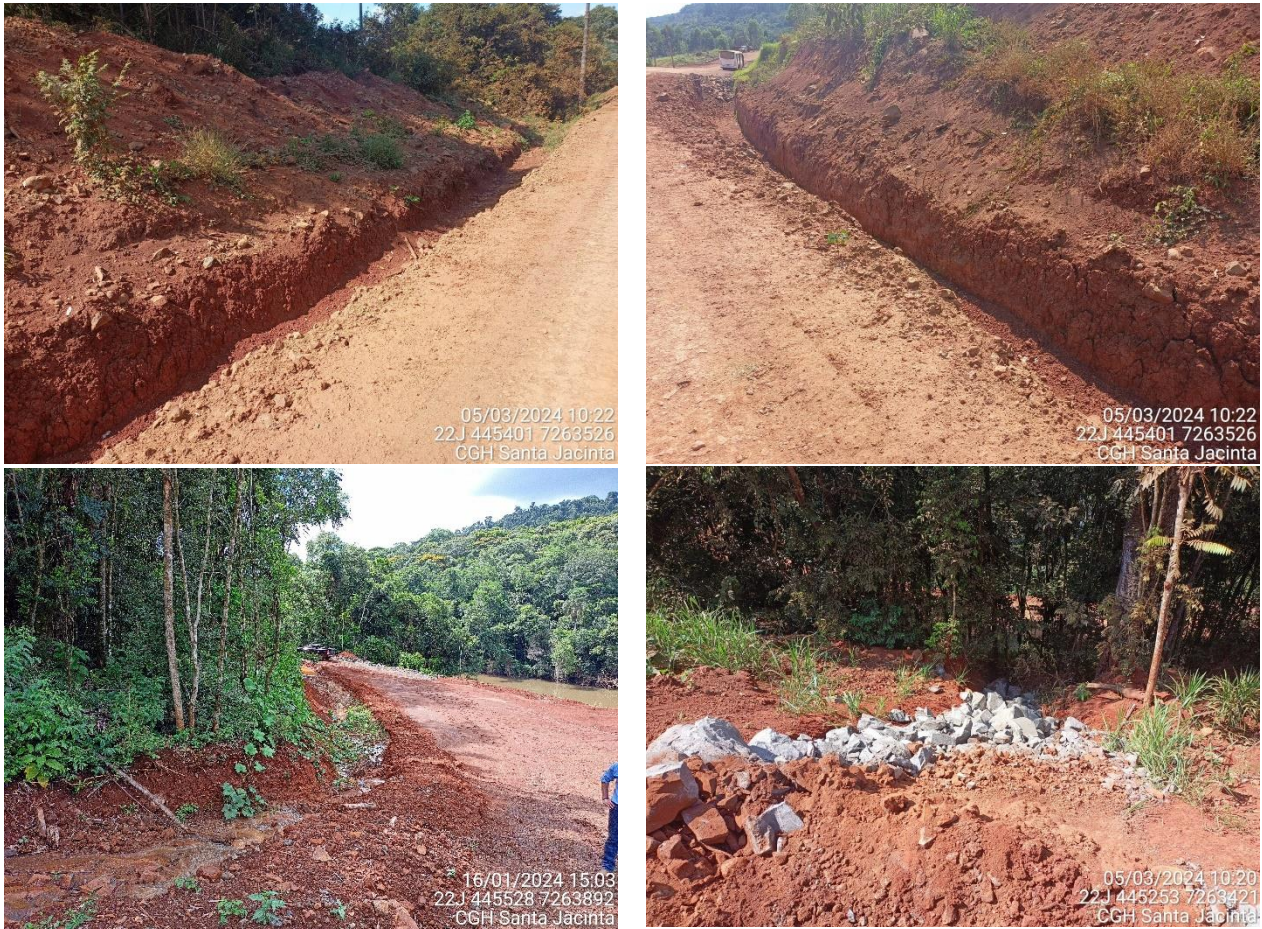
Figura 9: Canaletas de drenagem no entorno das estradas de acesso do sítio de obras e apresentação do filtro de matacos para evitar a lixiviação de sedimentos para o leito do rio na margem esquerda da casa de força.
